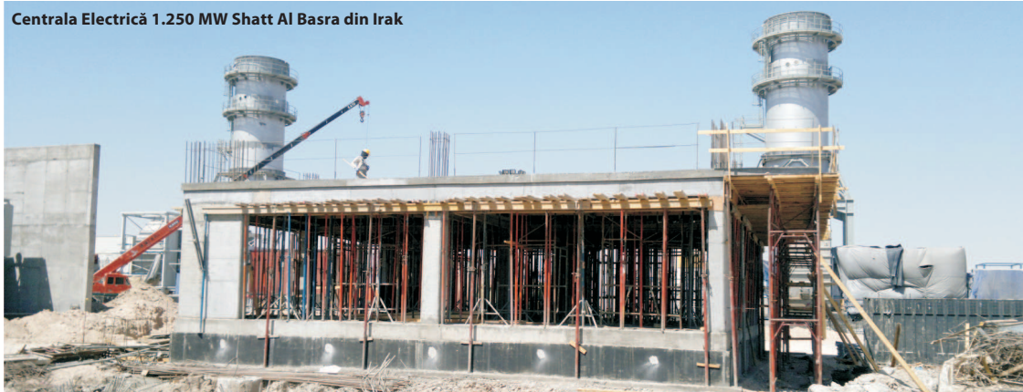
Centrala Electrică 1.250 MW Shatt Al Basra din Irak
